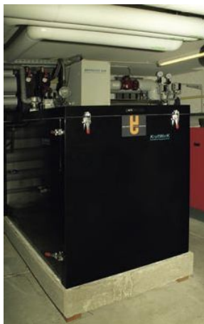
Wärme und Strom direkt vor Ort: BHKW der Berliner Energieagentur in der WBG „Am Ostseeplatz“
